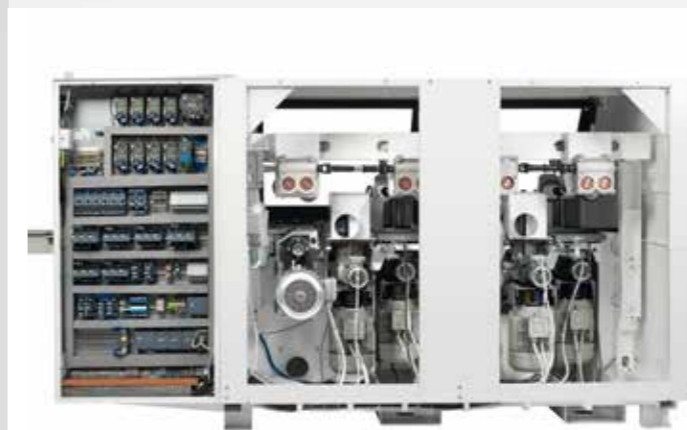
Quadro elettrico con componentistica Siemens
